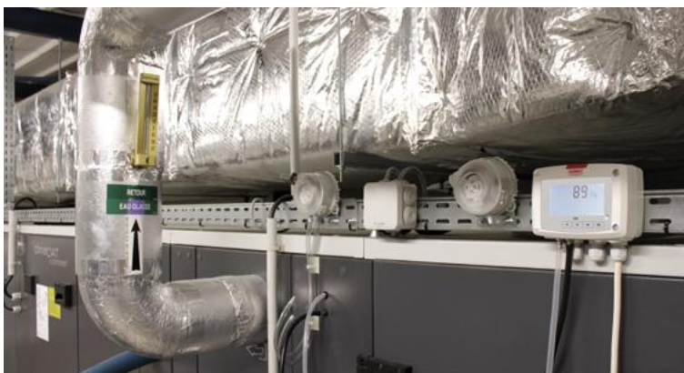
CP210-R in der Lüftungsanlage einer Industrieanlage.
